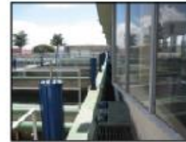
11 - VISTA DOS FILTROS LOCALIZADOS À FRENTE DA SALA DE MANOBRA (LADO DOS DECATADORES)
