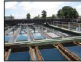
8 - VISTA DOS DECANTADORES
