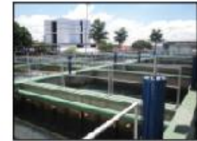
12 - VISTA DOS FILTROS FRONTAIS E DE LANTERNA
