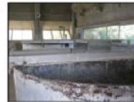
18 - VISTA DAS UNIDADES DE PREPARO DE PRODUTOS QUÍMICOS NO INTERIOR DO DEPOSITO QUE, AFLUENTE, ENCONTRAM-SE DESATIVADAS
