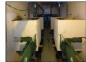
18. VISTA DO CORREDOR COM AS TUBULAÇÕES DE VEDAÇÃO E BANDEIRA DOS FILTROS, LOCALIZADO ENTRE OS FILTROS FRONTAIS E DE CANTADORES
